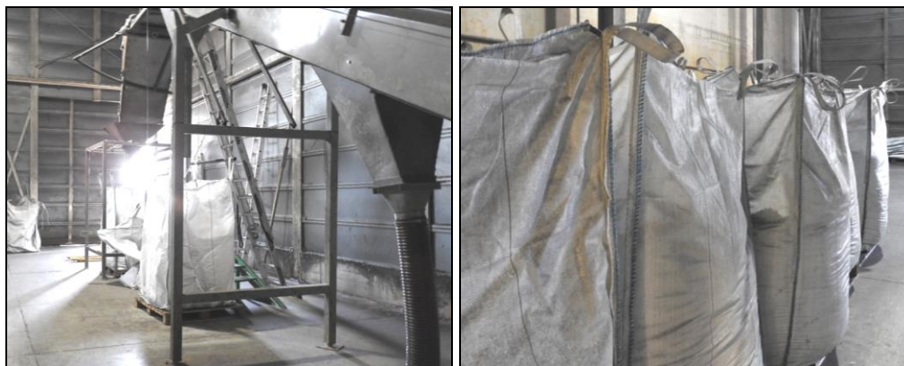
Gumeni granulati se transportira do silosa (lijevo) iz kojeg se pune big-bag vreće (desno)
