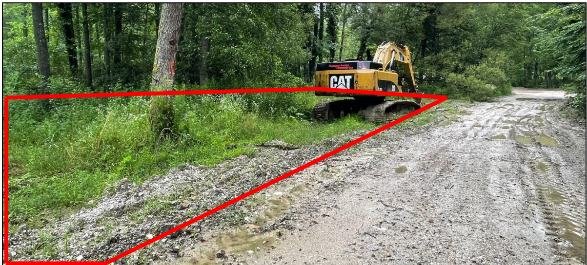
Slika 11 Mjesto na kojem je trebala biti izvedena vodonepropusna površina (površina obrubljena crvenom linijom) za smještaj privremene baze gradilišta i parking mehanizacije (fotografija Maxicon d.o.o.)
