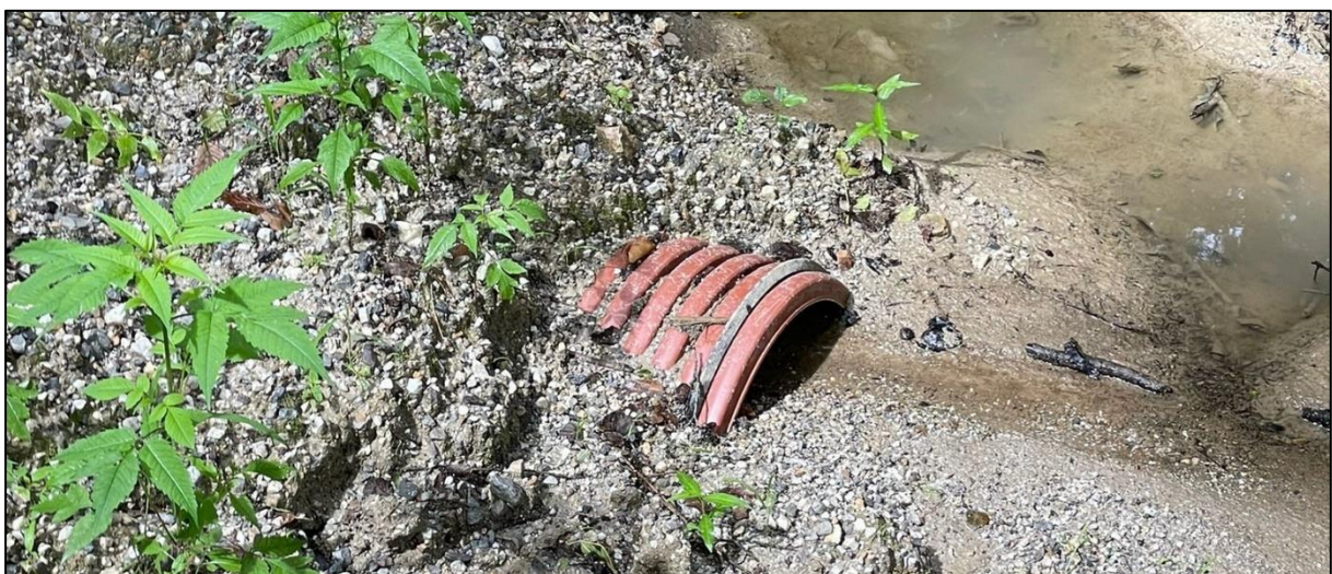
Slika 9 Djelomično blokiran propusti oborinskih voda i bujičnih tokova uz šumski put, stanje početkom srpnja 2023. (fotografija Maxicon d.o.o.)
